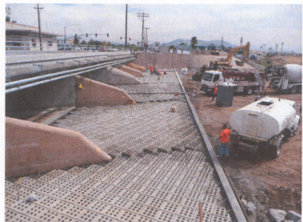
Fig. 27 - Enviroflex ® Installed Needs Closure Pour
