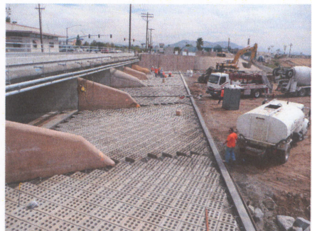
Fig. 27 - Enviroflex ® Installed Needs Closure Pour
